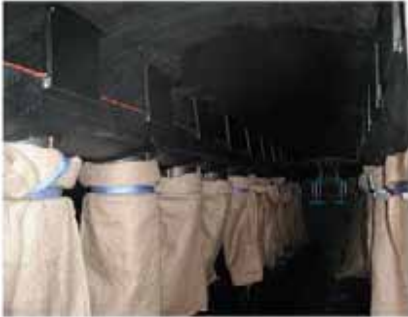
Abbildung 5: Filtersackanlage einer Schutzhütte kurz nach Inbetriebnahme
